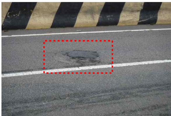
보수미흡, 방수층 소실 (상행 S2)
