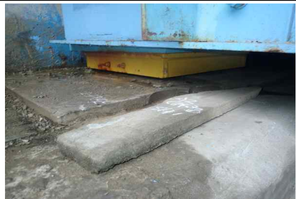
받침몰탈 파손 (하행 A2 Sh1)
