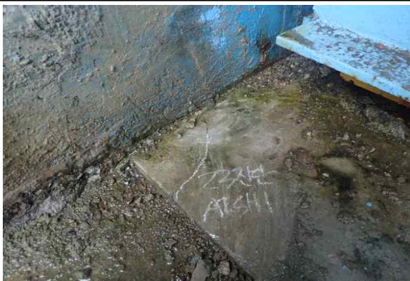
받침몰탈 균열(cw=0.2mm) (하행 A2 Sh1)
