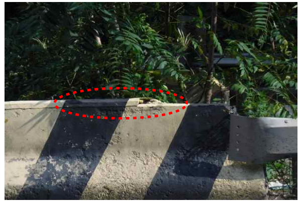
방호벽 파손 (하행 S1)
