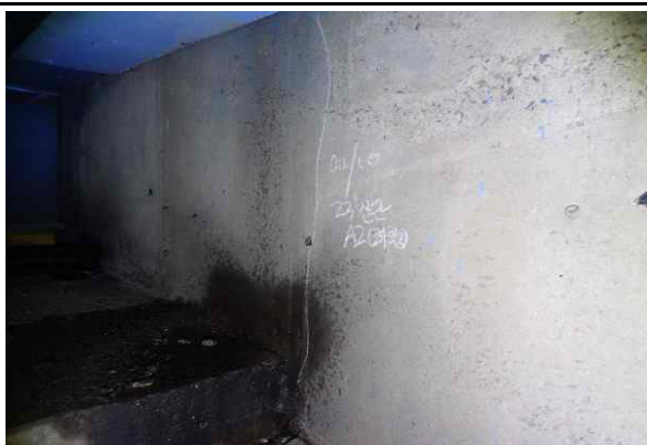
교대 홍벽 균열(cw=0.2mm) (하행 A2)
