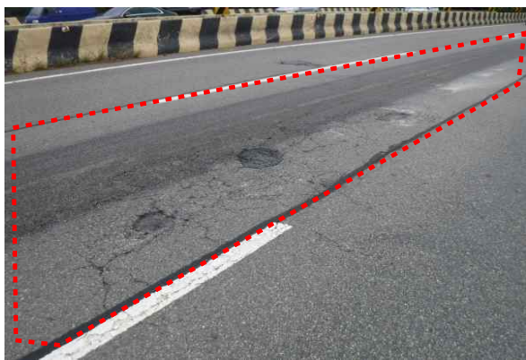
파손, 망상균열, 방수층 소실 (상행 S2)
