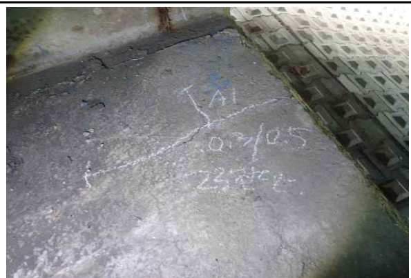
교대 벽체 균열(cw=0.3mm) (상행 A1)
