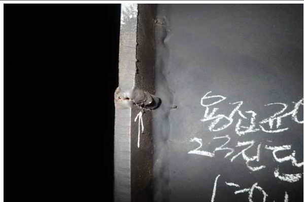
내부 격벽 용접균열 (하행 S3 G1 D30)
