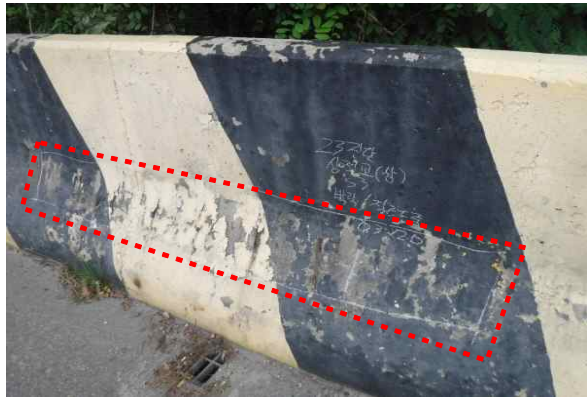
방호벽 박락 및 철근노출 (상행 S3)
