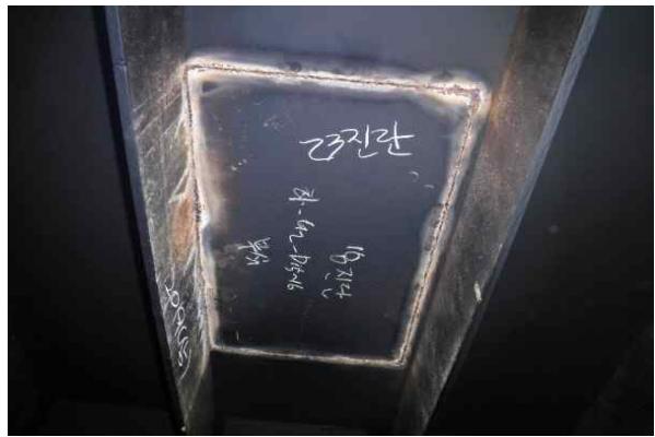
내부 작업구 용접불량/녹발생 (하행 S2 G2 UF)
